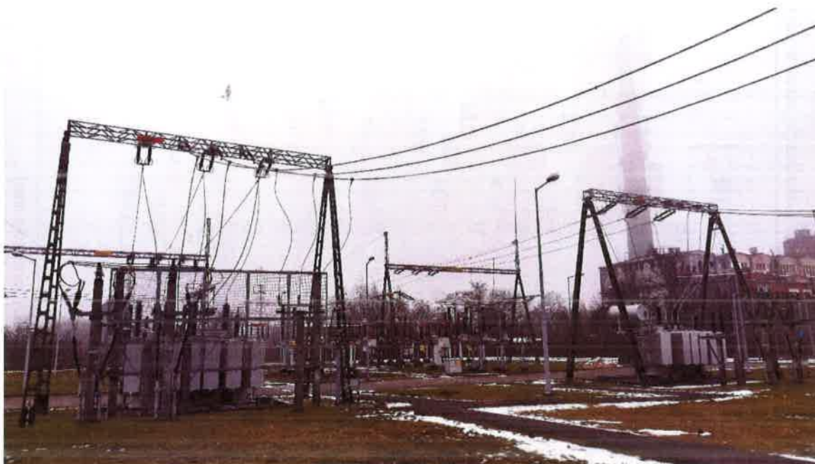
Zdjęcie nr 1. Stacja elektroenergetyczna 110/15 kV RPZ Fasty – widok fragmentu obiektu.
