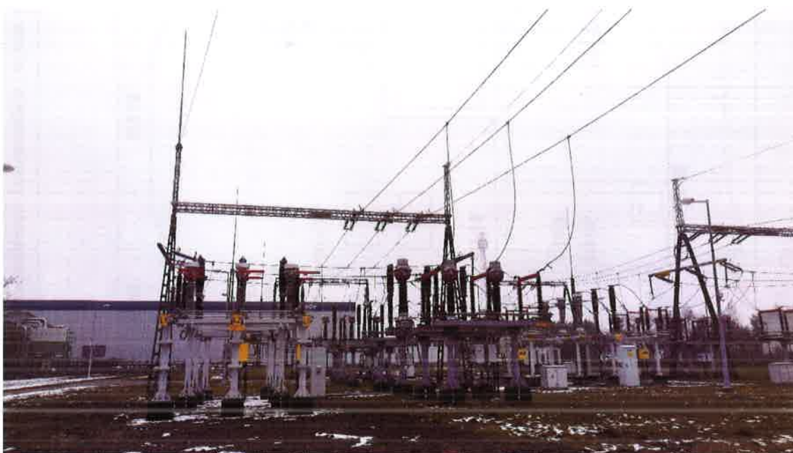
Zdjęcie nr 2. Stacja elektroenergetyczna 110/15 kV RPZ Fasty – widok fragmentu obiektu.
