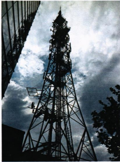
Widok obiektu wraz z zainstalowanym zespołem antenowym
