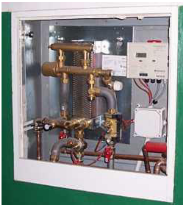
Rys. nr 11. Widok „Stacji mieszkaniowej c.w.u.” wg danych MPEC
