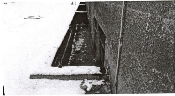
Fot Nr 2 - istniejące studnie doświetlające - brak odpływu, w przypadku nowych studni i braku kanalizacji deszczowej, należy przewidzieć wpusty chłonne
