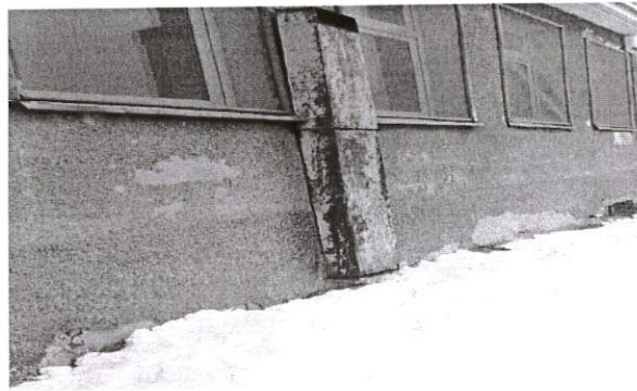
Fot Nr 4 - istniejący kanał zetowy wentylacji do demontażu
